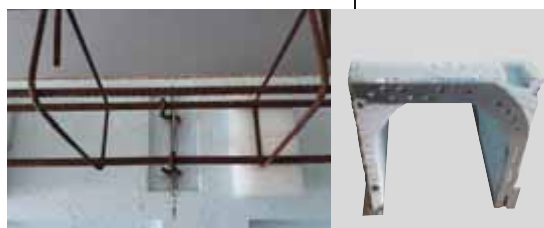
RENFORT DANS COFFRE PERMETTANT DE REPRENDRE LE CHAÎNAGE DU LINTEAU ET ASSURER LA REPRISE « OBLIGATOIRE* » DE LA TRAVERSE HAUTE DE LA MENUISERIE
